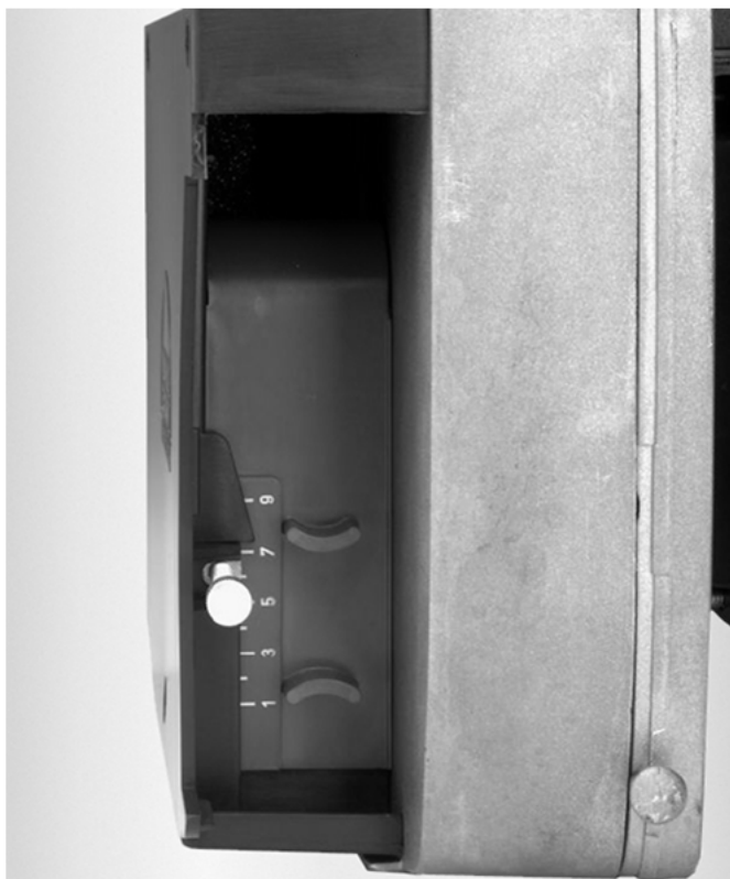
Abb. 12: Luftansaugchalldämpfer GE 1H sowie Schieber mit Skala und Fixierung
