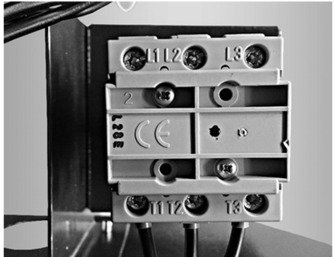
Abb. 23: Detailansicht des Hauptschalters Q1
