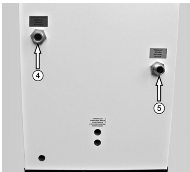
Abb. 12: Anschlüsse für Speicher bzw. weiteren Heizkreis
