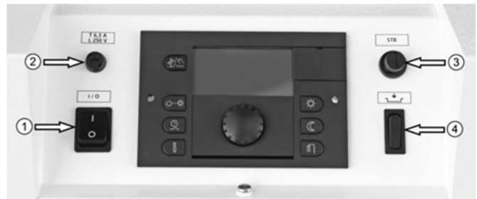
Abb. 35: Unit-Schaltfeld mit Sicherheits- und Funktionselementen
