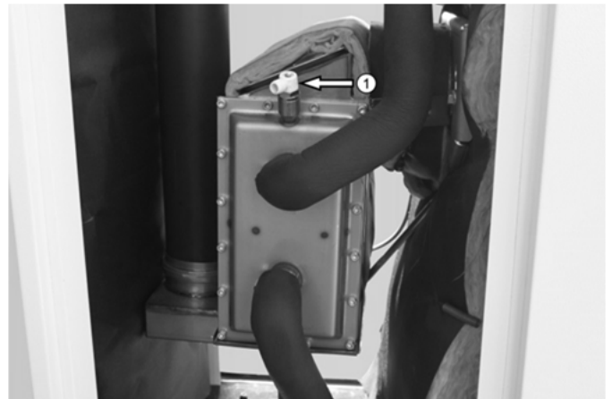
Abb. 21: Entlüfter ① des Abgaswärmetauschers
