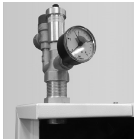
Abb./Fig. 3: Platzierte Kesselsicherheitsgruppe Groupe de sécurité de la chaudière en place Gruppo di sicurezza caldaia installata
