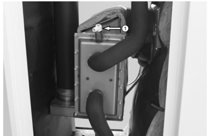
Abb. 21: Entlüfter ① des Abgaswärmetauschers
