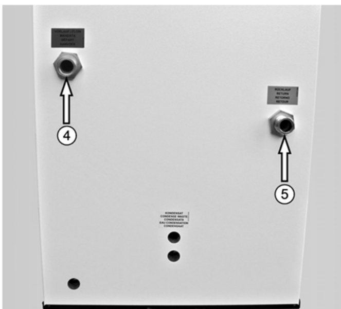
Abb. 12: Anschlüsse für Speicher bzw. weiteren Heizkreis
