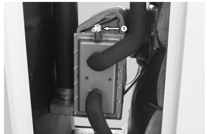
Abb. 21: Entlüfter ① des Abgaswärmetauschers
