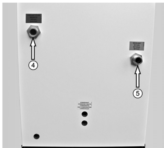
Abb. 12: Anschlüsse für Speicher bzw. weiteren Heizkreis
