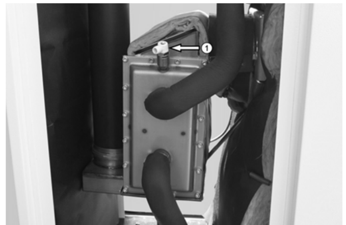
Abb. 21: Entlüfter ① des Abgaswärmetauschers
