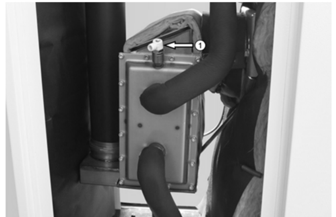
Abb. 21: Entlüfter ① des Abgaswärmetauschers
